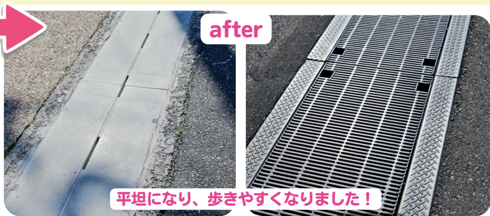
コンクリート蓋割れ・段差
